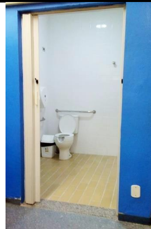
Banheiro Funcionário 1, o mesmo foi adaptado para acessibilidade
